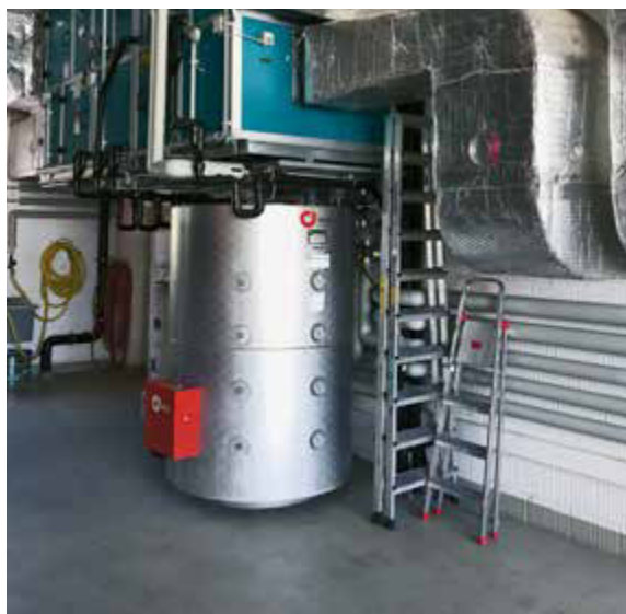
Brauchwarmwasserspeicher mit Abwärmenutzung der Tumblerabluft und Wärmehückgewinnung aus dem Kühlprozess.
